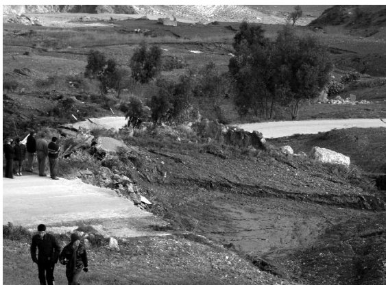
Uno scorcio della frana sulla strada prov. da Mussomeli a Valle (foto Felice Stagnitto)
